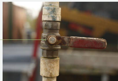
Llave de paso de agua, de operación manual, para el riego en los bancos de germinación
