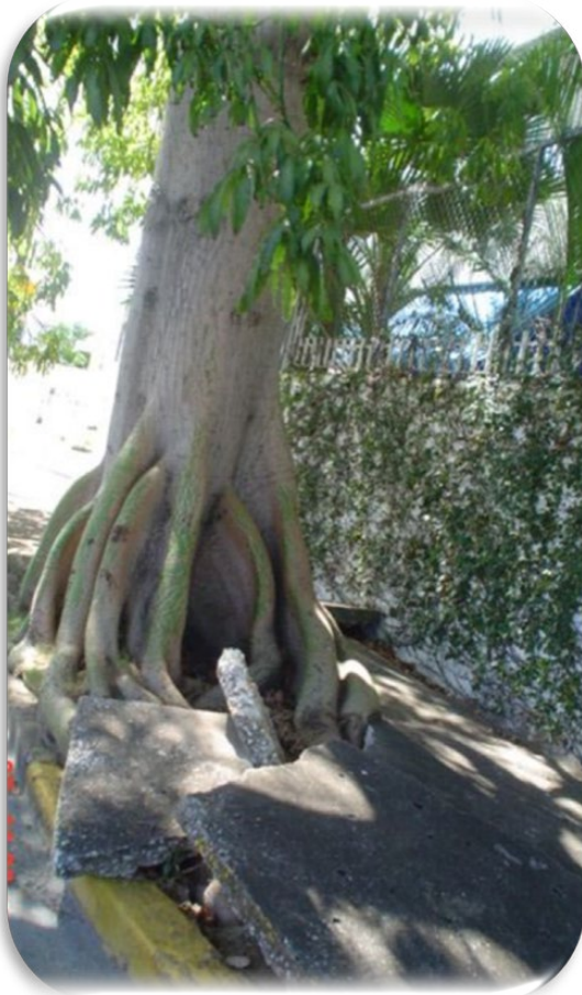
Daño a la infraestructura por selección inapropiada
