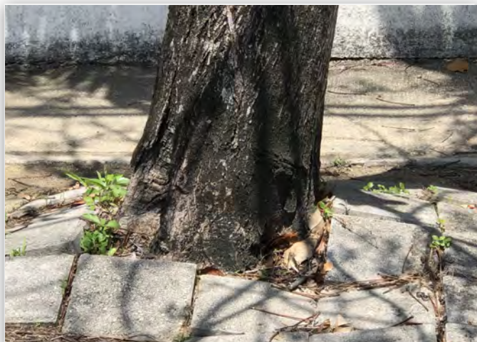
Daño por construcción
