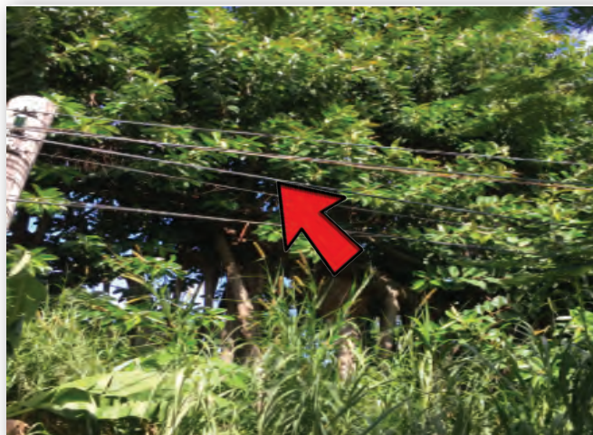
Daño por construcción en copa
